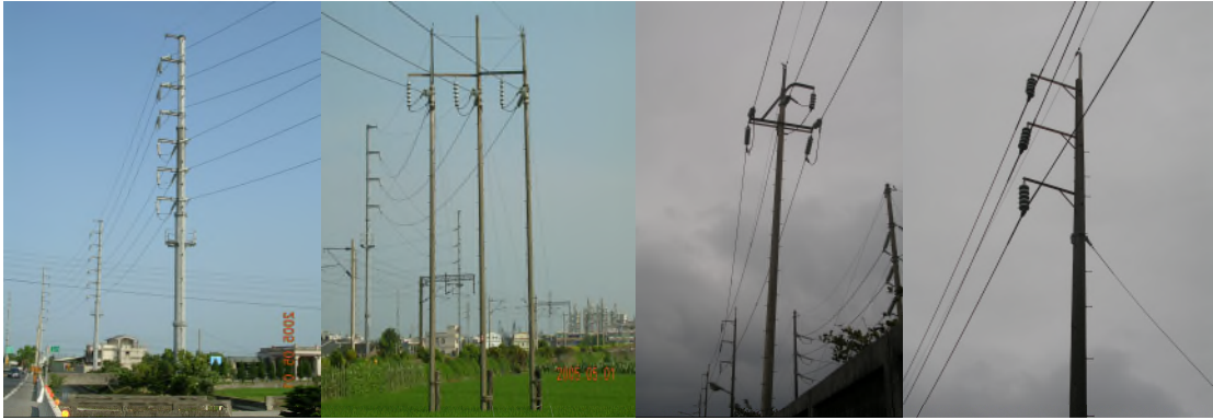
圖 2-5 電桿型支持物外觀(大部份用於 69 千伏)
