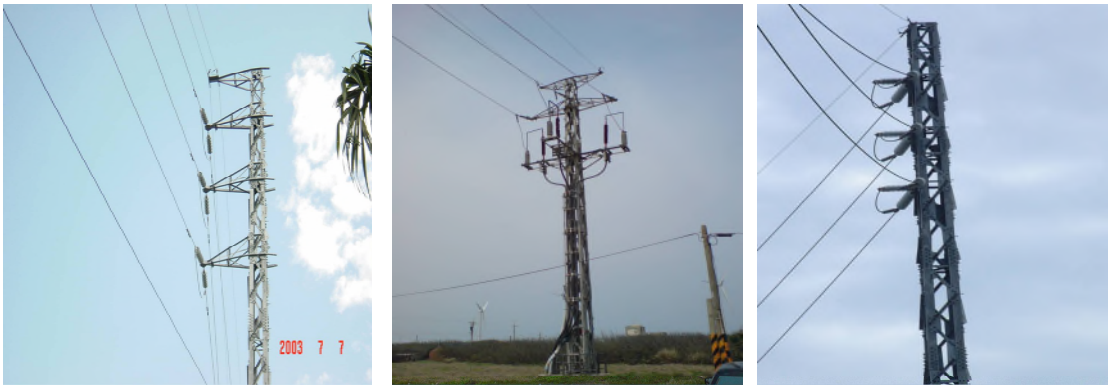
圖 2-6 鐵柱型支持物外觀(大部份用於 69 千伏)
