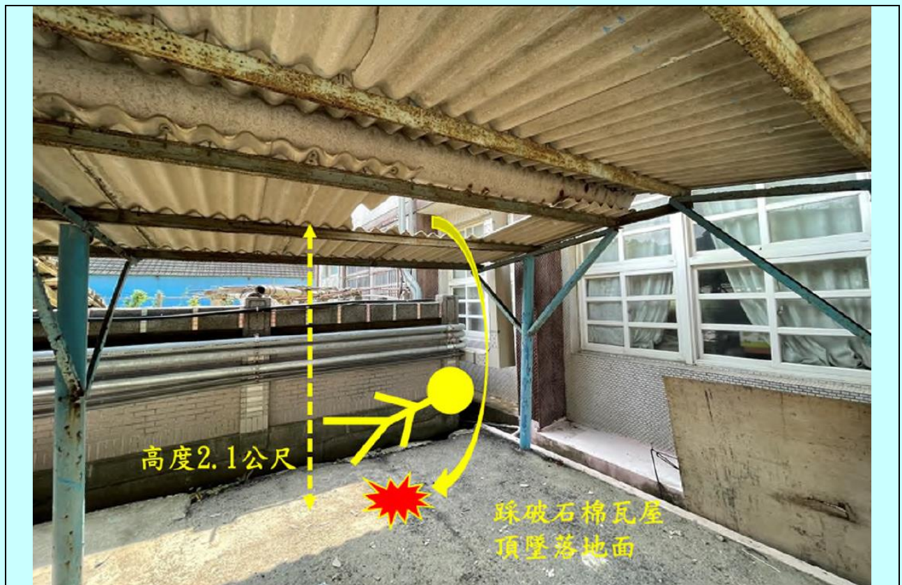
附照 說明：罹災者踩破石棉瓦屋頂
