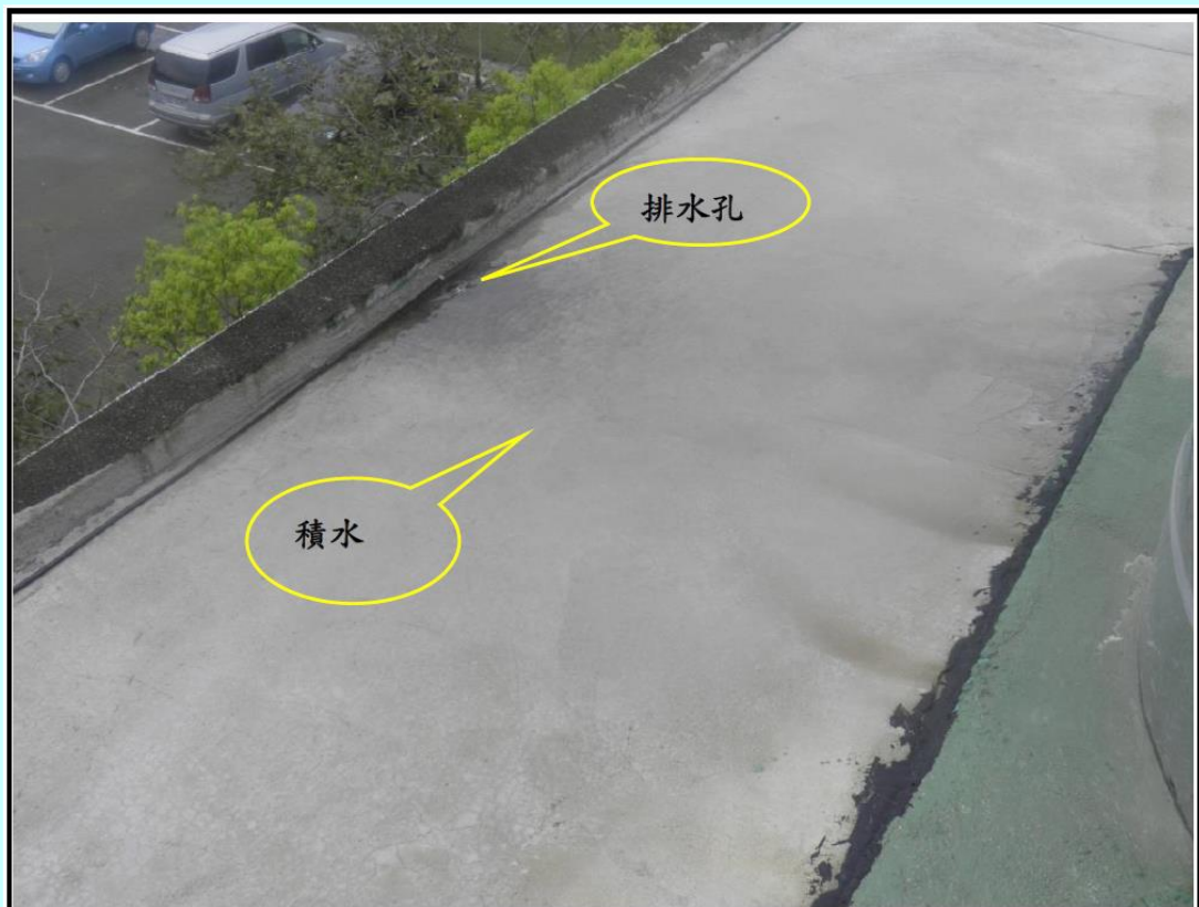
照片 5 南棟三樓教室屋頂邊緣排水孔旁有積水
