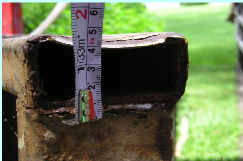
吊籃支架斷裂處一端顯示角鐵焊接處部分已嚴重銹蝕
